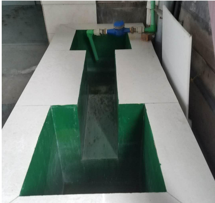
图 7-3 废水处理设施出口
